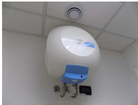
Figura 4.14 - Particolare di un boiler elettrico per la produzione di acqua calda sanitaria
