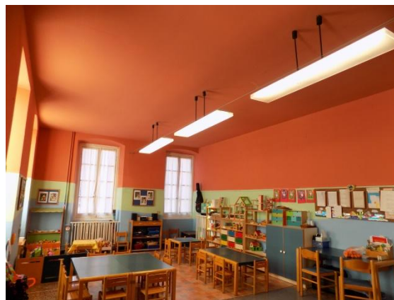
Figura 4.15 - Particolare dei corpi illuminanti ubicati nelle aule
