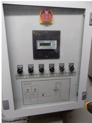
Figura 4.8 – Centralina di controllo in CT
