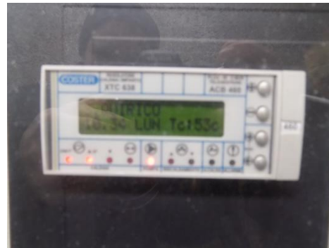
Figura 4.9 – Particolare della centralina di controllo in CT
