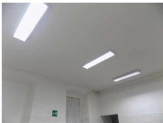
Figura 4.16 - Particolare dei corpi illuminanti ubicati nel refettorio
