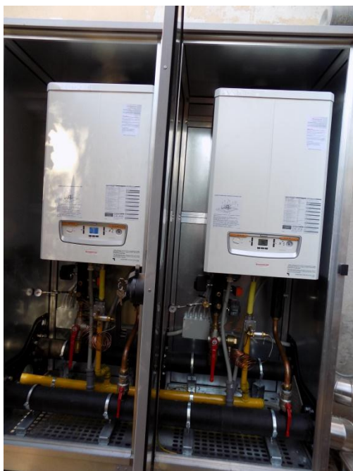
Figura 4.12 - Particolare del sistema di generazione del calore
