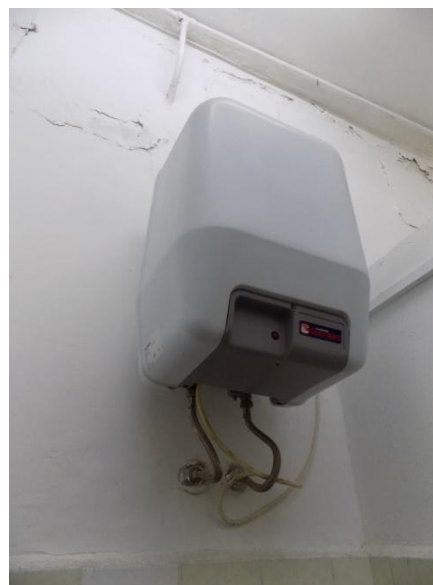
Figura 8.7 – Particolare del boiler elettrico installato per produzione di ACS
